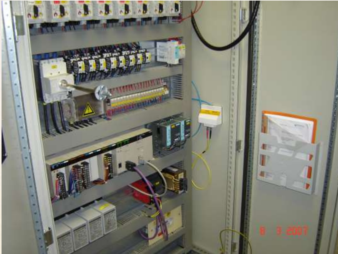
IZVEDENA ELEKTRIČNA RAZDELILNA OMARA
