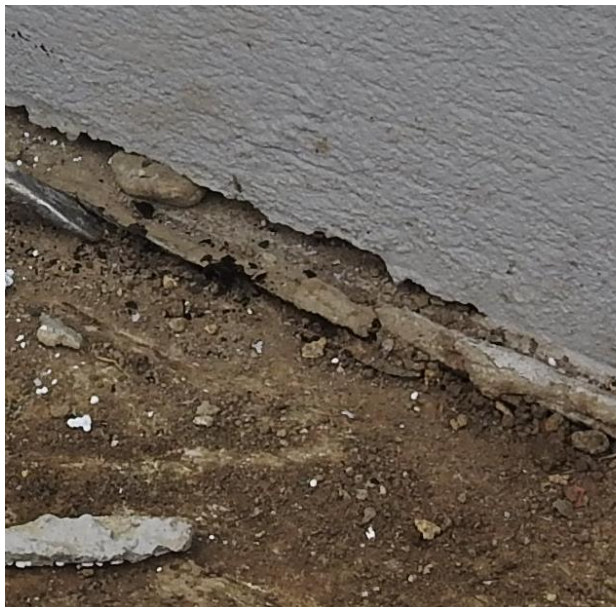
Slika 34: Prikaz nepopolne zlepljenosti hidroizolacije v predelu zunanjega roba vgrajene hidroizolacije
