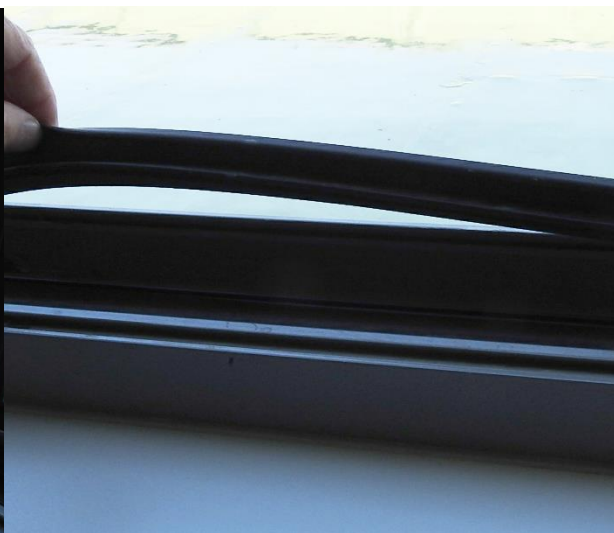
Slika 20: Prikaz dislocirane tesnilne gume vgrajenega okna, ki je vgrajena v predelu naleganja krila na okvir
