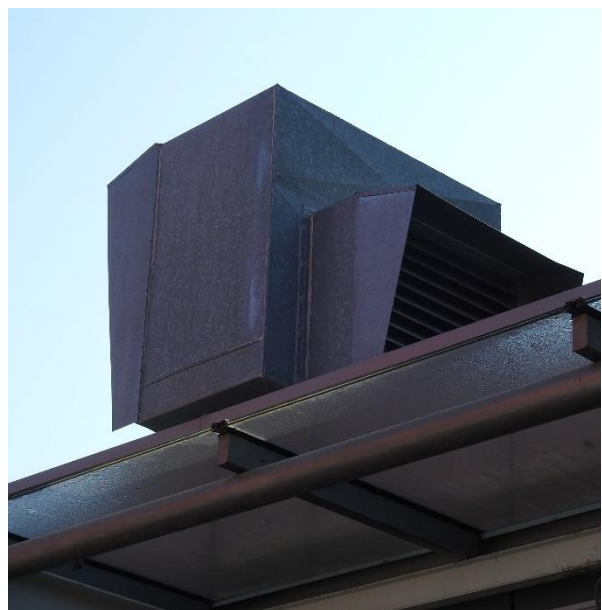
Slika 22: Prikaz pogleda na rešetke zračnika skozi katere je možen vdor meteorne vode v notranjost objekta
