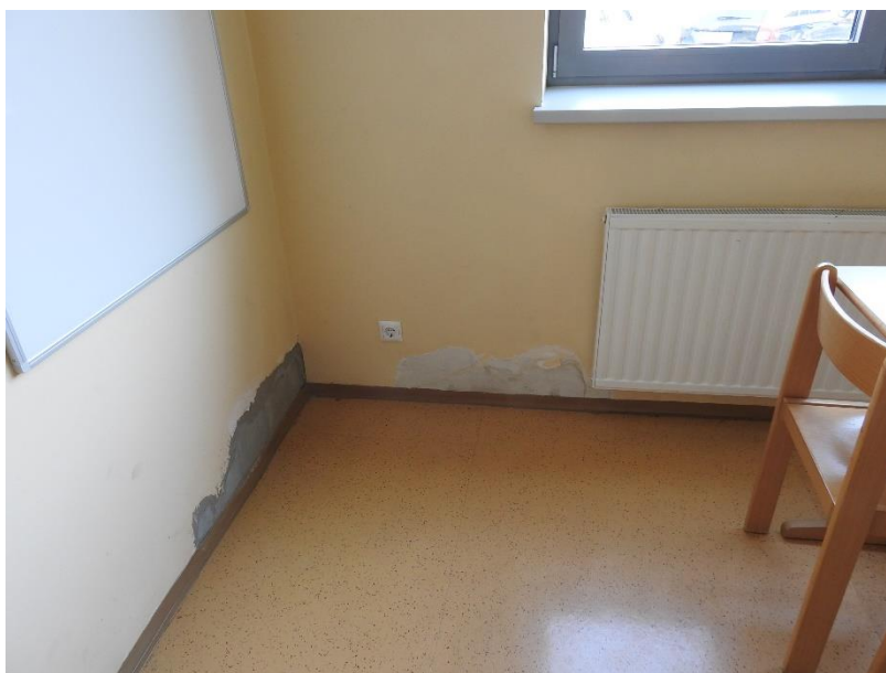
Slika 18: Prikaz sledi vlaženja zidov ob SZ vogalu učilnice Strojništvo, št. 15
