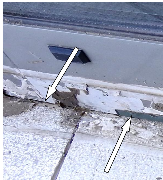
Slika 27: Prikaz luščenja zaključnega sloja zasteklitvenega okvirja in manjkajočega dela dodatno nameščenega tesnilnega traku
