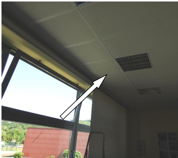
Slika 15: Prikaz lokacije zamakanja v predelu vzhodnega hodnika ob kabinetu 205
