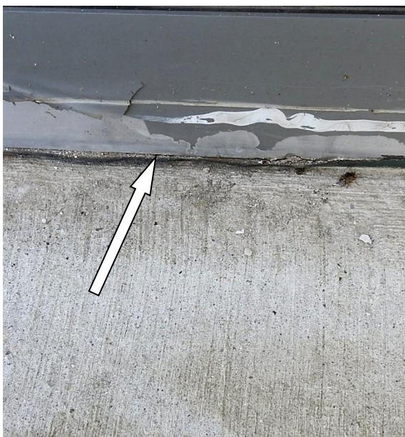
Slika 26: Prikaz luščenja zaključnega sloja zasteklitvenega okvirja in nezlepljenost dodatno nameščenega tesnilnega traku
