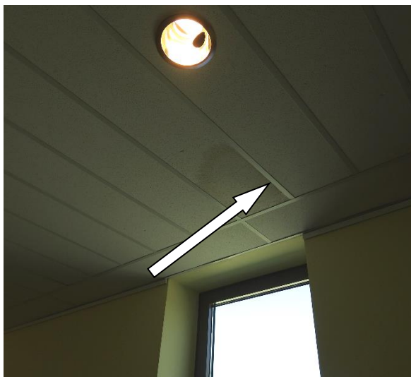
Slika 4: Prikaz lokacije zamakanja, desno od 6. okna od SZ vogala objekta
