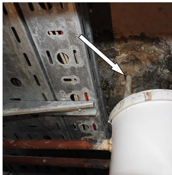
Slika 24: Prikaz pogleda intenzivne sledi precejanje vode v predelu preboja cevi centralnega ogrevanja
