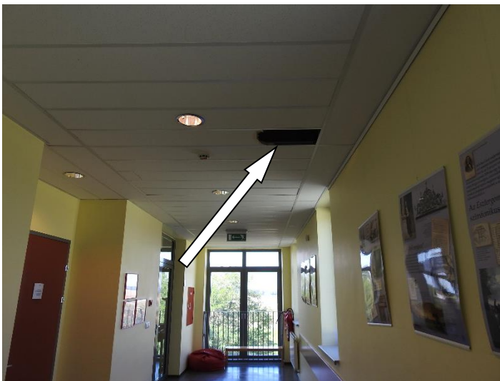
Slika 2: Prikaz lokacije zamakanja, desno od 1. okna od SZ vogala objekta
