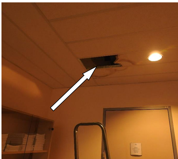
Slika 11: Prikaz lokacije zamakanja v predelu vzhodnega hodnika ob kabinetu 205
